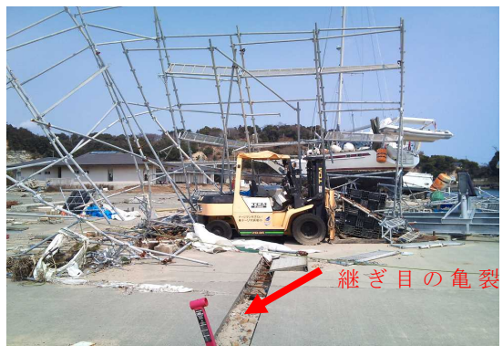
幅50cmほどの亀裂が入った ボートヤードの継ぎ目
